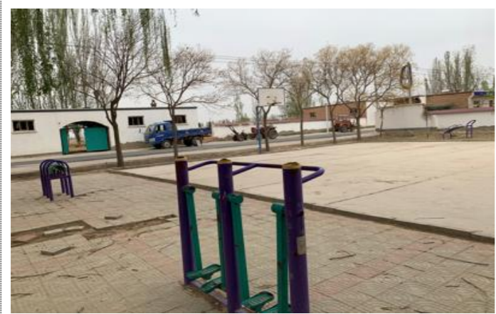
图 2-6-3 六队活动广场地面损坏
