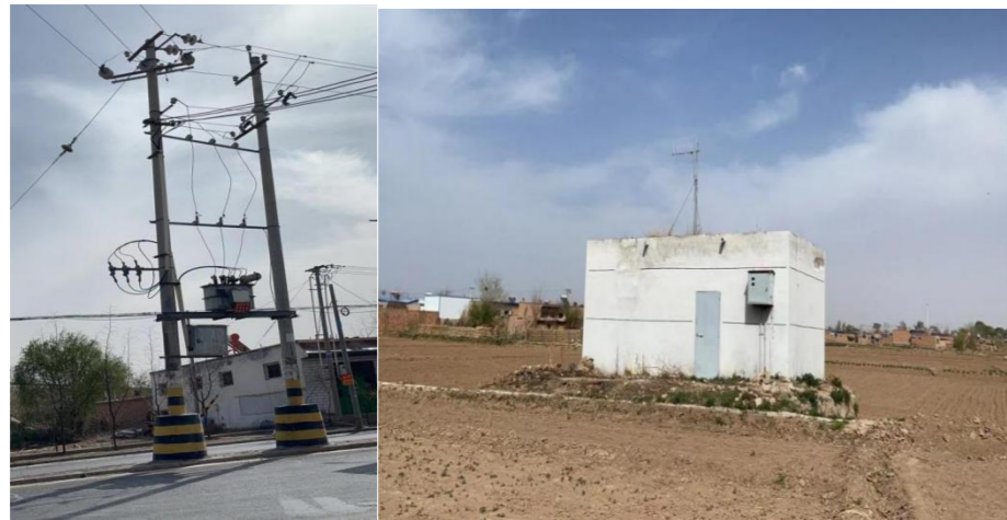
图 2-16 中渠村电力设施图
